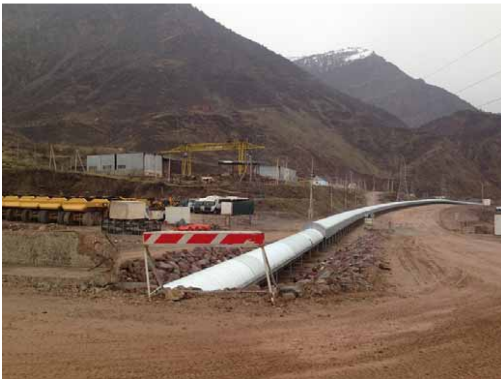
Часть конвейерной линии для строительства Рогунской ГЭС
